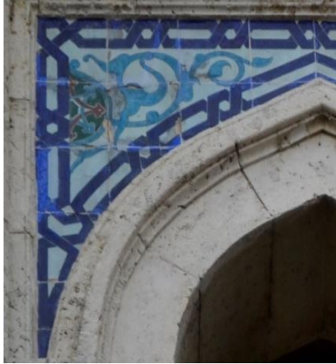
Fotoğraf 1: Dördüncü Vakıf Han; yüzeyde sır kopması, bünyeden kopma ve tamamlama hataları (Ebru Köse arşivinden).
