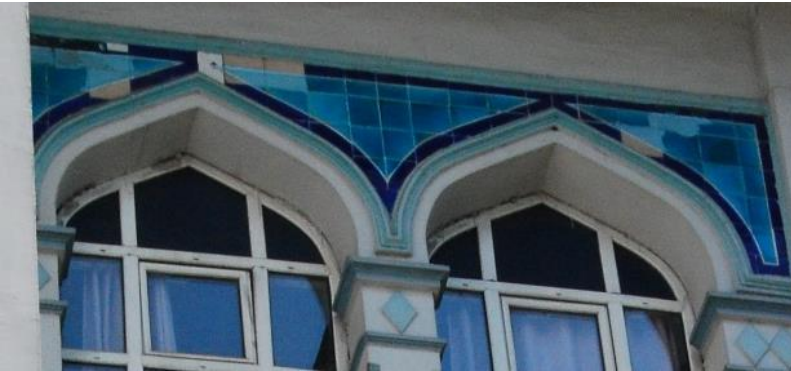
Fotoğraf 11: Çapa Fen Lisesi düşen çiniler ve tamamlama uygulamaları.
