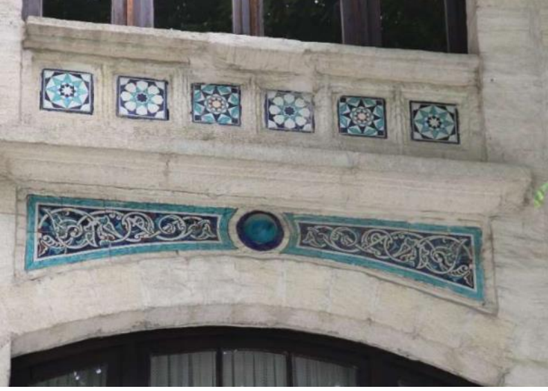
Fotoğraf 14: Tapu Kadastro Binası çinileri kirlilik, kılcal çatlaklar ve sır kopmaları.
