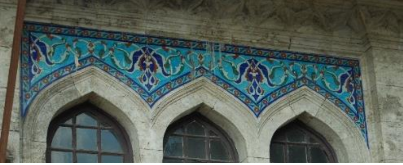
Fotoğraf 15: Birinci Vakıf Han çini yüzeyinde kirlenme, kopma ve çatlak.
